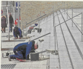
Zu kurz war das Geländer an der Außentreppe des neuen Hilda-Gymnasiums. Es wurde jetzt verlängert. FOTO: FREI
