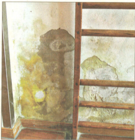
In Reinkultur gelb: Die sogenannten Aufblühungen des Chromsalzes unmittelbar neben einer Sprossenwand der Turnhalle.
