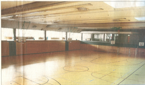
DER SCHEIN TRÜGT: Oft tropft es so heftig in die Fritz-Erler-Sporthalle, dass Elmer aufgestellt werden müssen. Das Dach ist undicht und soll nun in Etappen repariert werden. Die Kosten dafür betragen – wie der Bauausschuss gestern erfuhr – rund eine halbe Million Euro. Foto: Wacker
