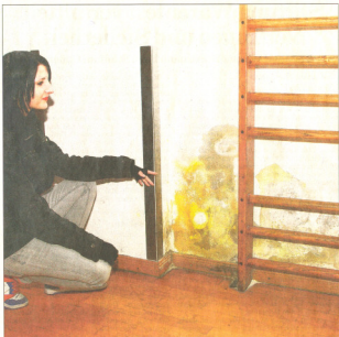
SCHÖN GELB sehen die Ausblühungen an der Wand der Turnhalle des Hilda-Gymnasiums zwar aus, sie sind aber gesundheitschädlich. Deshalb ist die Turnhalle ab sofort unbenutzbar. Foto: Wacker
